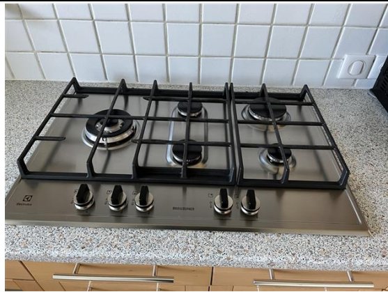
Photo n° PhGaz001 Localisation : Etage 1 : Séjour / Cuisine Table de cuisson ELECTROLUX (Type : Non raccordé) Localisation sur croquis : Point001
