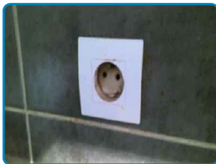
Anomalie B.4.3 h sur Install. n°1
