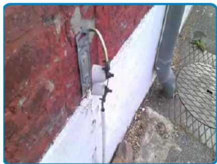
Anomalie B.3.3.3 a sur Install. n°1 (TERRE)
