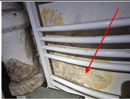
Photo n° PhTer001 Localisation : Sous-Sol - Cave Ouvrage : Murs (Béton peint) Parasite : Champignon de pourriture cubique du type conioflore SP (Humidité importante) Indices : présence de filaments (ou hyphes) (infestation(s) importante(s)) Informations complémentaires : Absence de ventilation, Hygrométrie mesurée supérieure à 20%, Pièce très encombrée, Présence d'une forte humidité
