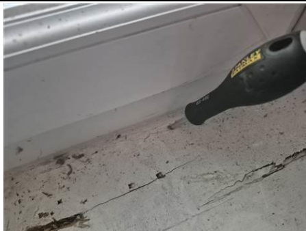
Photo n° PhTer002 Localisation : Rez de chaussée - Salon Ouvrage : Menuiserie (Bois) tablette de fenêtre Parasite : Champignon de pourriture cubique du type conioflore SP Indices : dégradation superficielle du bois, présence de déformation(s) ponctuelle(s), présence de filaments (ou hyphes), présence de pourriture cubique (dégradation(s) importante(s))
