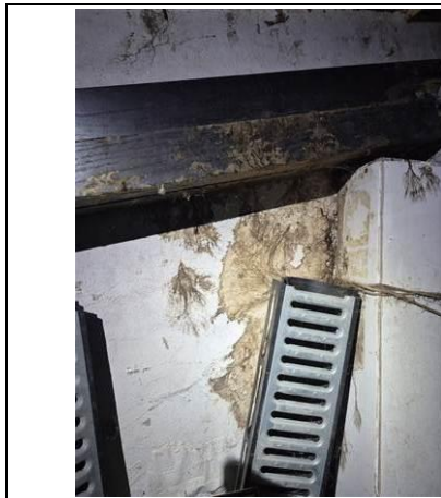
Photo n° PhTer001 Localisation : Sous-Sol - Cave Ouvrage : Murs (Béton peint) Parasite : Champignon de pourriture cubique du type conioflore SP (Humidité importante) Indices : présence de filaments (ou hyphes) (infestation(s) importante(s)) Informations complémentaires : Absence de ventilation, Hygrométrie mesurée supérieure à 20%, Pièce très encombrée, Présence d'une forte humidité
