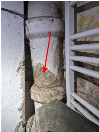
Photo n° PhTer001 Localisation : Sous-Sol - Cave Ouvrage : Murs (Béton peint) Parasite : Champignon de pourriture cubique du type conioflore SP (Humidité importante) Indices : présence de filaments (ou hyphes) (infestation(s) importante(s)) Informations complémentaires : Absence de ventilation, Hygrométrie mesurée supérieure à 20%, Pièce très encombrée, Présence d'une forte humidité
