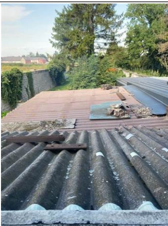
Photo n° PhA004 Localisation : Rez de chaussée - WC Ouvrage : 1 - Couvertures, Toitures, Terrasses et étanchéités - Plaques ondulées et planes Partie d'ouvrage : Plaques en fibres-ciment (y compris plaques « sous tuiles ») Description : Plaques en fibres-ciment (y compris plaques « sous tuiles »)
