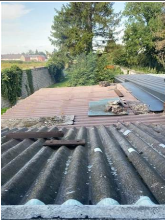
Photo n° PhA003 Localisation : Rez de chaussée - CELLIER Ouvrage : 1 - Couvertures, Toitures, Terrasses et étanchéités - Plaques ondulées et planes Partie d'ouvrage : Plaques en fibres-ciment (y compris plaques « sous tuiles ») Description : Plaques en fibres-ciment (y compris plaques « sous tuiles »)
