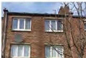
Fenêtres dépourvues d'amenées d'air
