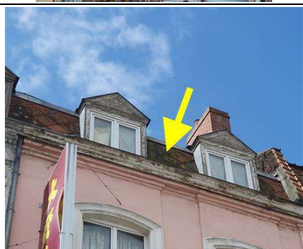
Photo n° PhA002 Localisation : Parties extérieures Ouvrage : Toiture Partie d'ouvrage : Brisi Description : Ardoise en fibre ciment
