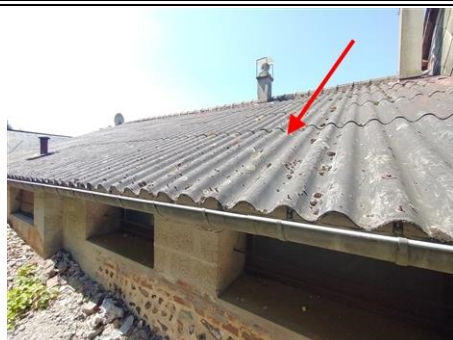
Photo n° PhA001 Localisation : Rez de chaussée - Garage 1; Combles - Combles 3 Ouvrage : 4. Eléments extérieurs - Toitures Partie d'ouvrage : Plaques (fibres-ciment) Description : Plaques (fibres-ciment)
